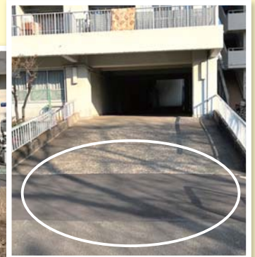
危険な段差解消 （河原町団地12号棟）
