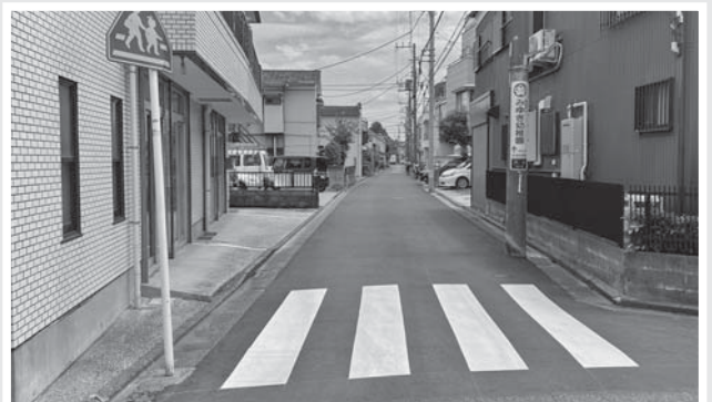
●老朽化した道路の路面補修 （小向町 11-22 付近から 19-17-1 付近まで約 200mが老朽化によりアスファルトを補修）
